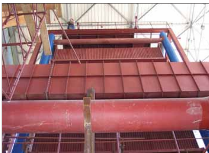
Нови вреловодни котлоа (ВКВ)
